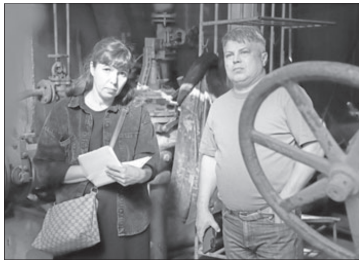
Инициатор выезда на газовую котельную по улице Пролетарской депутат Игорь Лебедев и его коллега Светлана Хомутина с интересом оценивали состояние оборудования, которое в основном работает с 1974 года и нуждается в замене.
